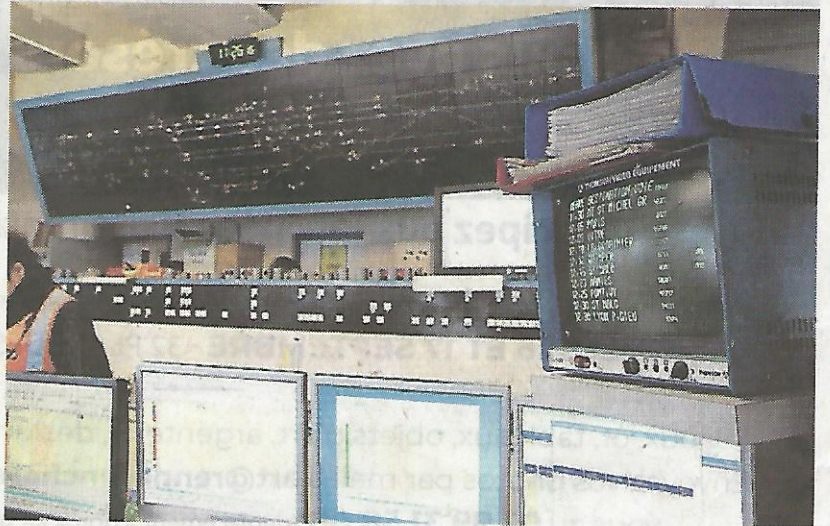
Le poste d'aiguillage de Rennes date de 1941.
