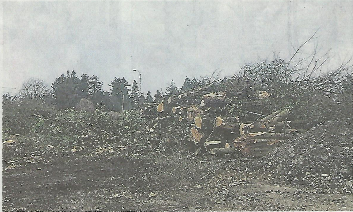
La parcelle concernée par les travaux d'abattage d'arbres se situe au niveau de l'ancienne usine de la tannerie du Trublet aux prairies Saint-Martin.
