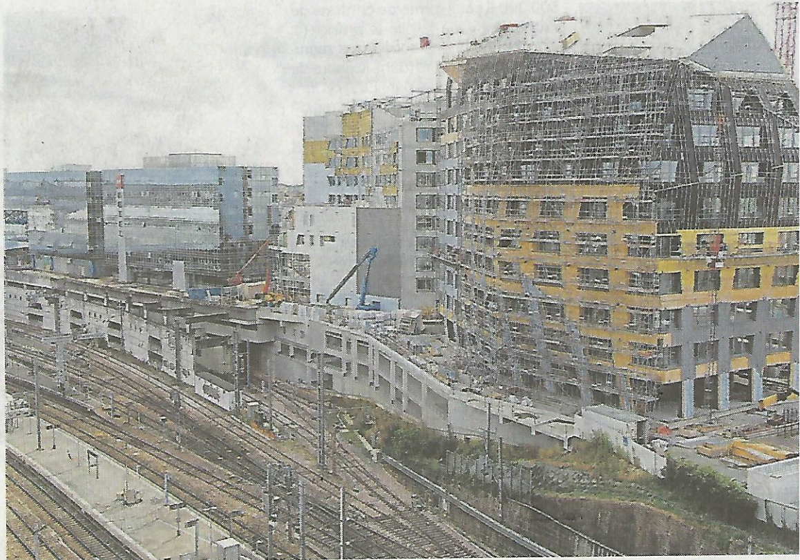
Le programme Identity, à EuroRennes, le nouveau quartier d'affaires près de la gare. Il comprend trois immeubles avec 23 500 m 2 de bureaux.
